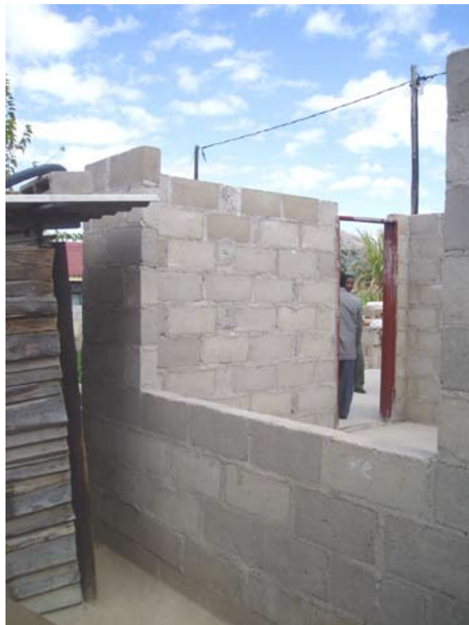
De bouw van woningen in Hobhouse vordert langzaam maar gestaag. Na het leggen van een fundering en een grondvloer worden de muren gemetseld van zelfgemaakte cementstenen. De (stalen) kozijnen worden er later in gezet.
